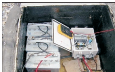
Fig.38. Tanquilla de alimentación de una estación remota.
